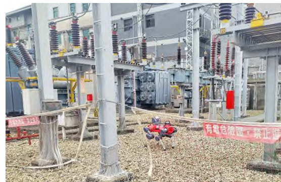
機器人於變電所進行自動巡檢
