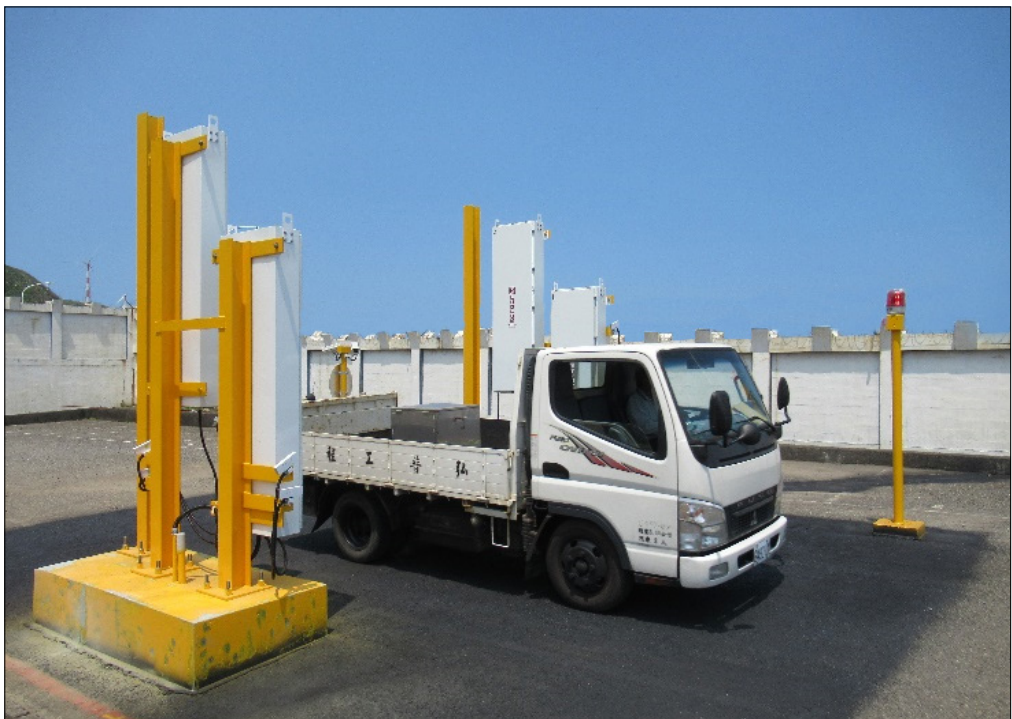
離廠偵檢設備 - 固定直立式輻射污染偵測系統。
