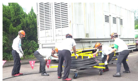
重大特大大事故策略指引演練：4.16 kV 電源車。
