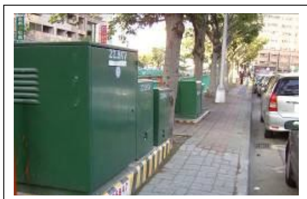
地下化後開關設備
