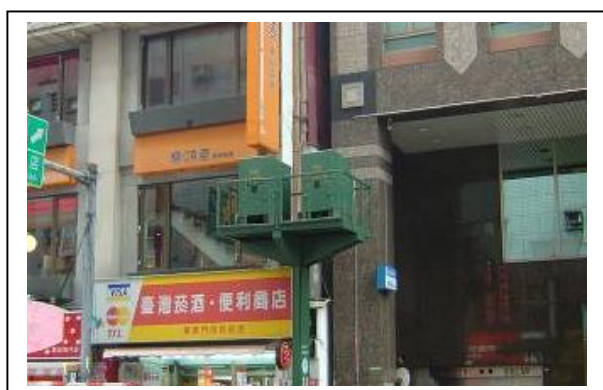
地下化後變壓器站台(2具組)
