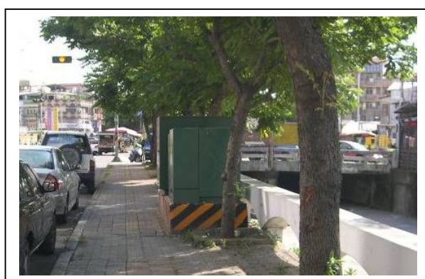
地下化後變壓器設備
