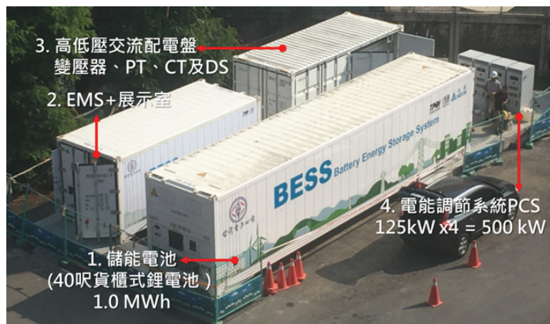
圖 3 鋰離子貨櫃式電能貯存系統 500 kW/1MWh
