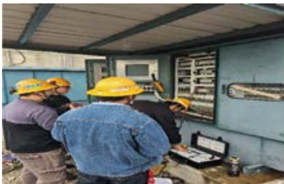
發電廠變電所監控儀表定期校驗
