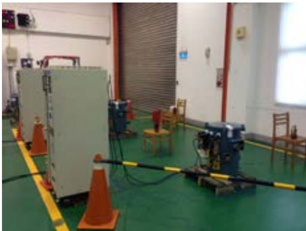
配電變壓器溫升試驗
