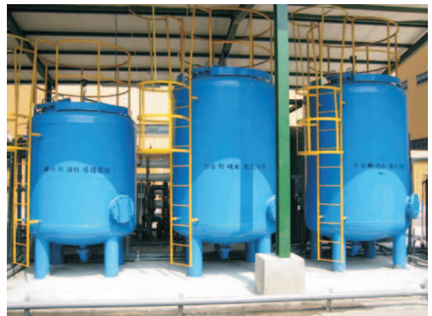
圖 5 活性炭過濾塔 (左 1) 及 AB 軟化槽 (右 2)
