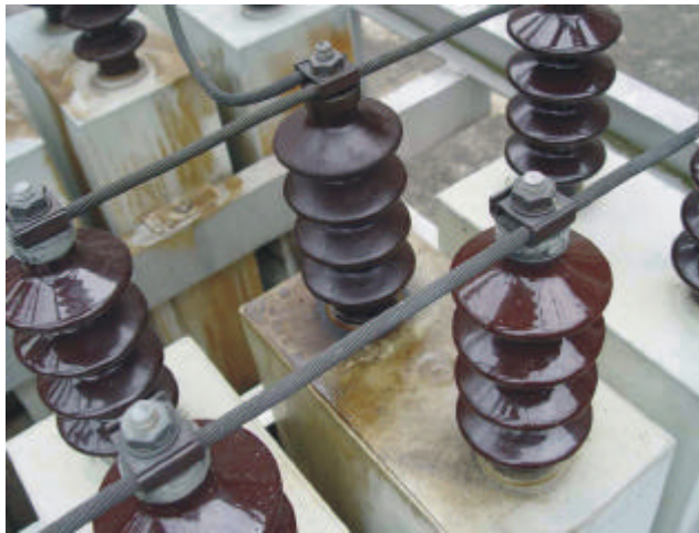
圖3 中間電容器套管上的接線方式。
