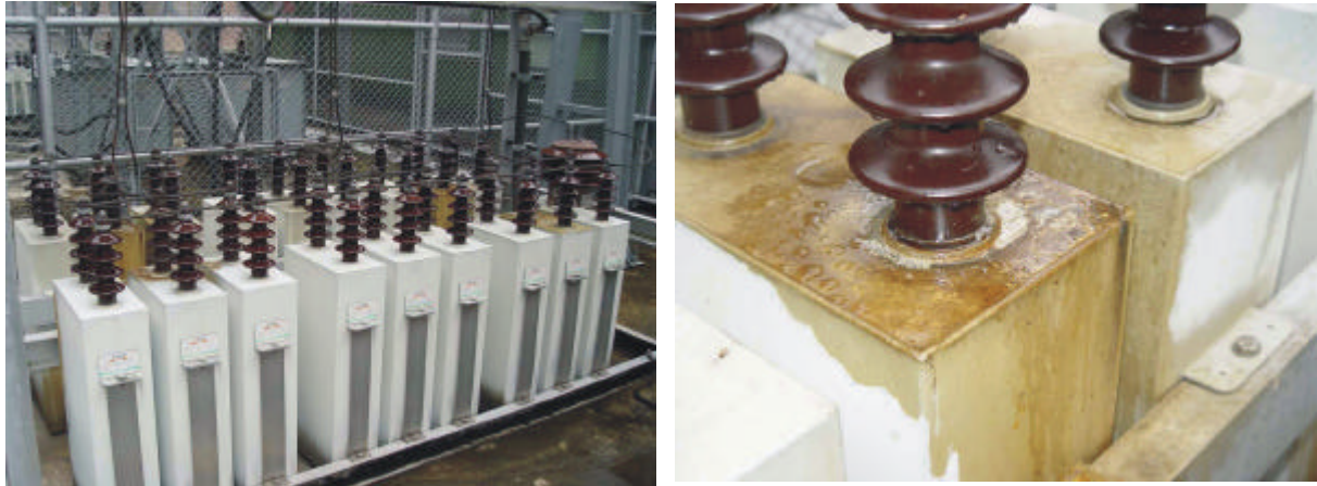
圖1 #1SFC濾波器電容器佈置及絕緣油滲漏的情形。
