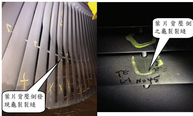
圖 1 低壓汽機動葉片(a)背壓側照片(b)龜裂情形照片
