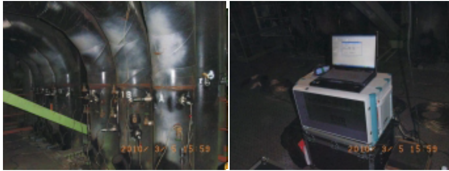
圖 2 粉煤流量多頻道微波測儀
