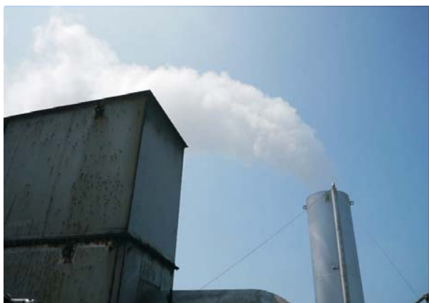
圖 1 大潭電廠之閃化蒸氣排放口
