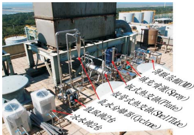
圖 2 閃化蒸氣水份回收試驗設備
