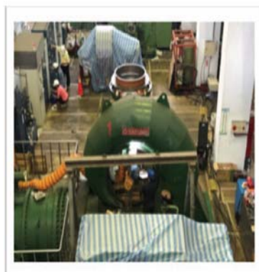
六龜機組發電機定子線圈測試 (107.07)
