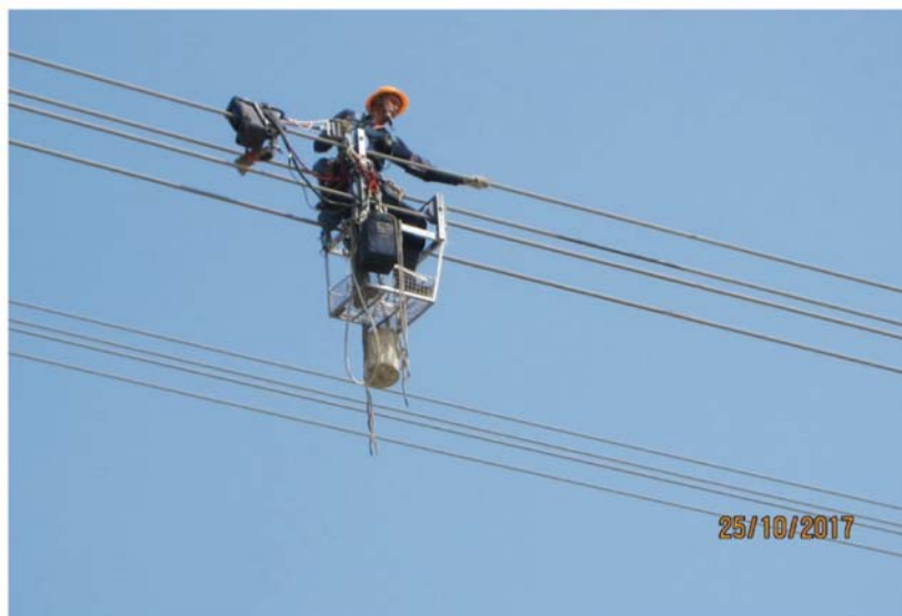
圖 1 架空導體腐蝕量化檢測實場驗證情形
