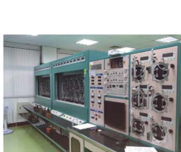
低壓 AMI 自動試驗電表設備
