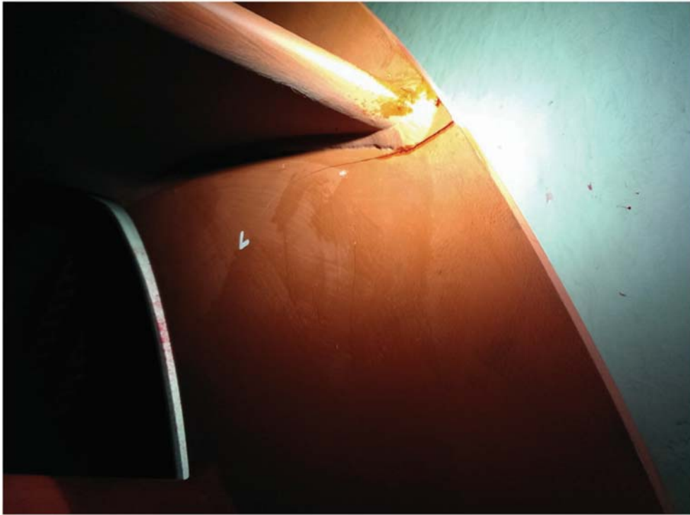
圖 1 發電機風扇發生龜裂問題
