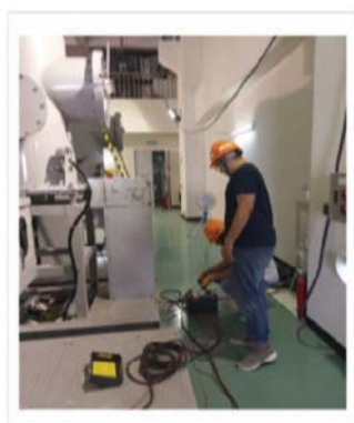
樟樹 D/S 161kV GIS 測試 (107.06)
