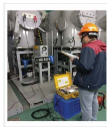
仙渡 E/S 配電變壓器測試 (107.04)
