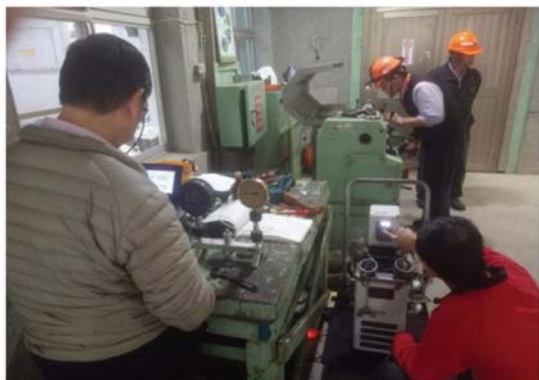
蘭陽發電廠溫度與壓力計定期試驗
