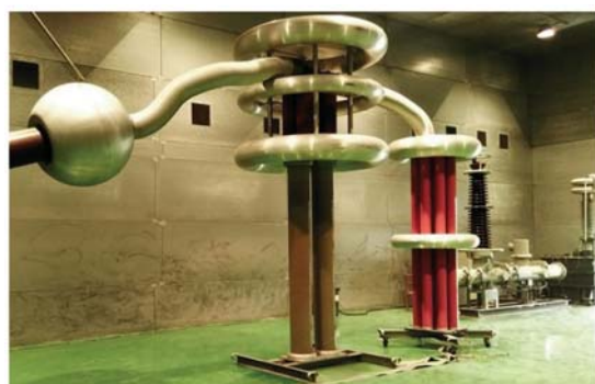
部分放電實驗室
