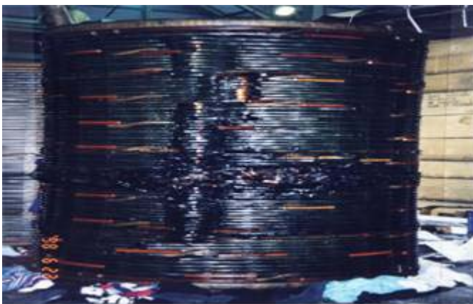
八十七年松山變電所二號主變事故後解體檢修T相二次線圈外側毀損照片
