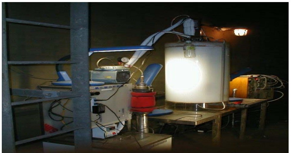
圖一、安裝於台中電廠五號機煙囪位置，應用以進行二氧化碳固定處理系統的實體結構圖。
