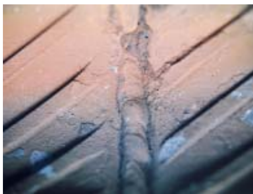
圖一、協和電廠結垢爐管表面觀察
