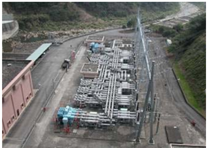
圖二、明潭抽蓄發電廠開關場全部GIS環境架構
