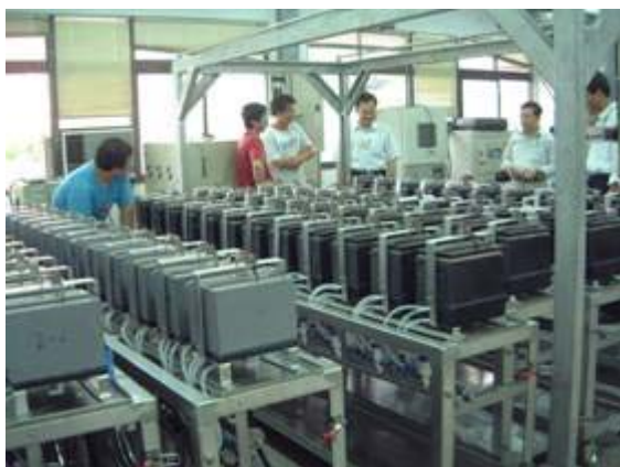
圖一、鋅金屬燃料電池貯電系統安裝測試
