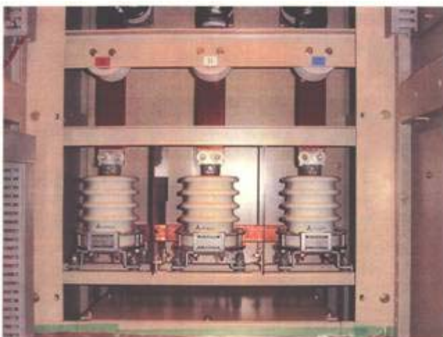
圖一、8.4kV 避雷器設置於 6.6kV 裝甲開關箱內
