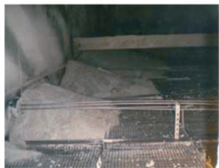
圖 2 觸媒表面局部飛灰沉積，呈緩降坡堆積
