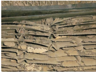
圖 1 觸媒支撐材局部破裂情形
