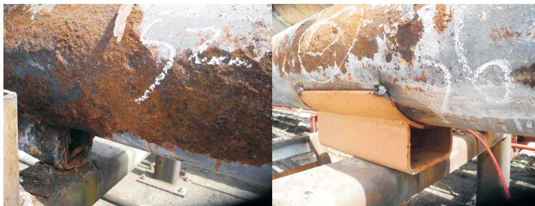
圖 6 左圖 S2~+F3 及右圖 S6~-F7 皆為嚴重腐蝕
