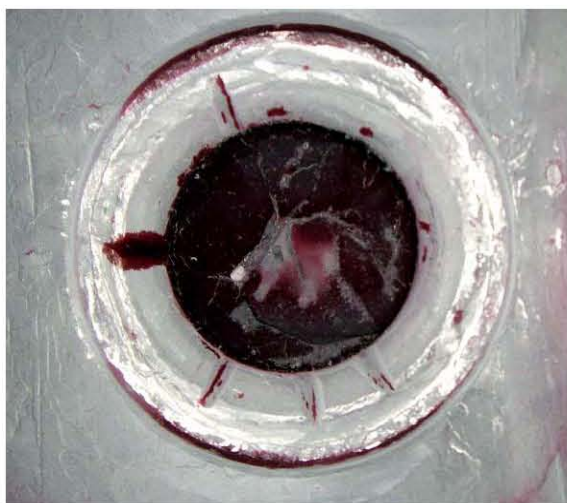
圖1 Gv閥座汽封環區研磨後龜裂裂縫之外觀
