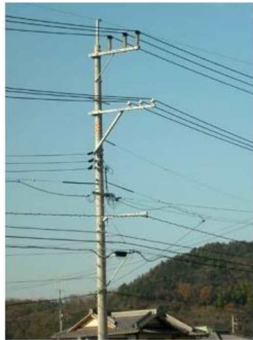
圖1 日本22kV與6kV三相線路全伸出共架裝置實景圖
