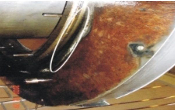
圖 2 明潭轉軸上之軸環於大修中發現鏽蝕嚴重
