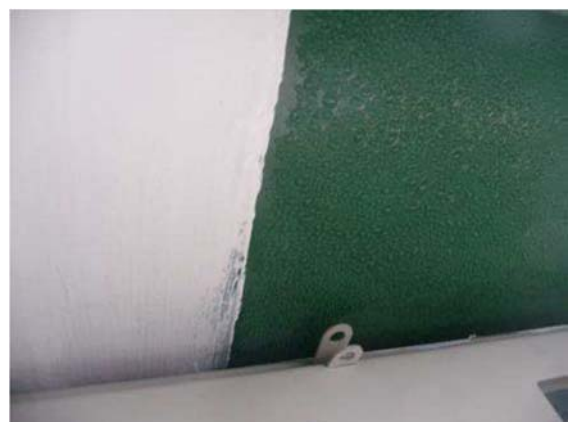
圖 2 有塗料的區域係乾的並無凝露，無塗料的區域則有凝露
