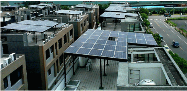
圖 1 陽光社區屋頂之太陽光電陣列
