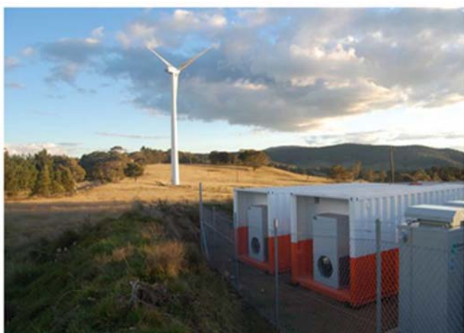
圖 1 澳洲 Hampton 風場搭配 1MW 儲能系統
