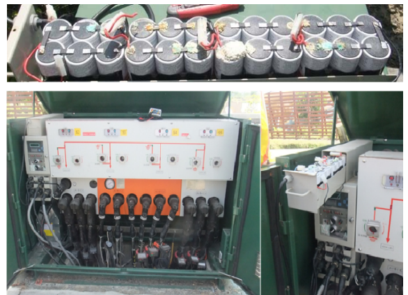
地下四路自動線路開關電池組腐蝕情形
