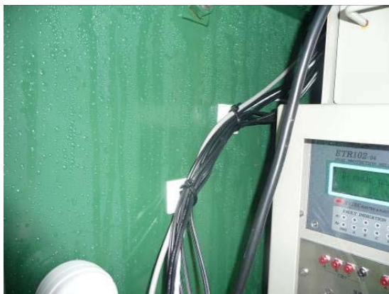
圖 1 開關箱內部側面凝露情況
