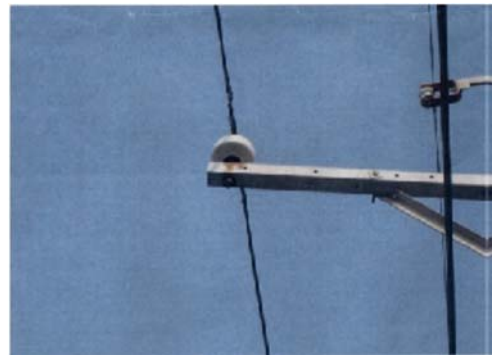
圖 2 高壓架空被覆線絕緣體腐蝕造成絕緣破壞實例
