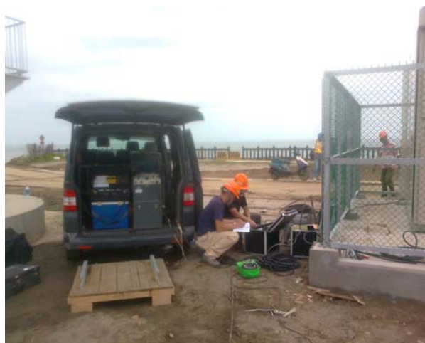
蘆竹風力 電力設備現場試驗
