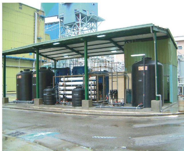
圖 2 逆滲透膜廢水回收系統設備
