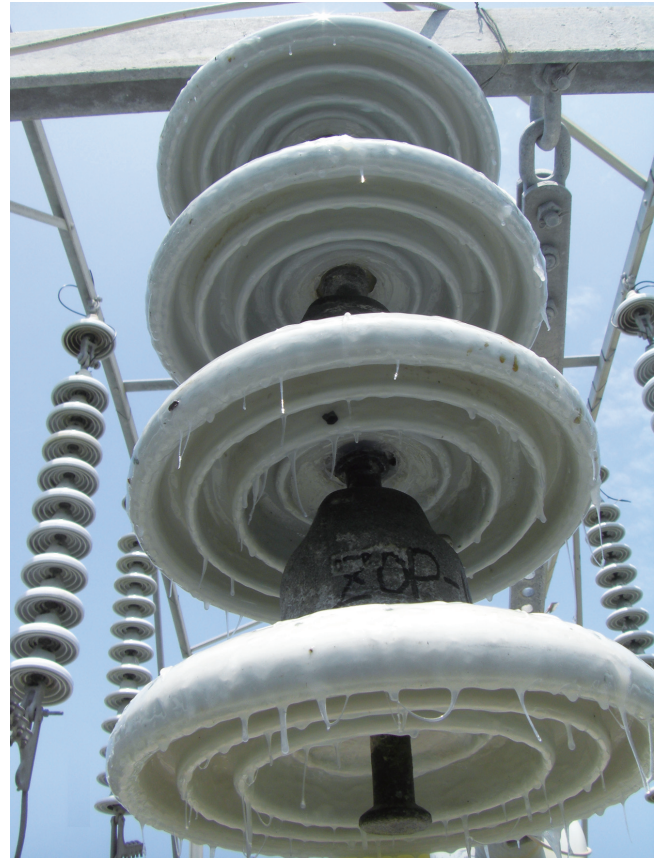
附著不良之矽油膏垂流嚴重
