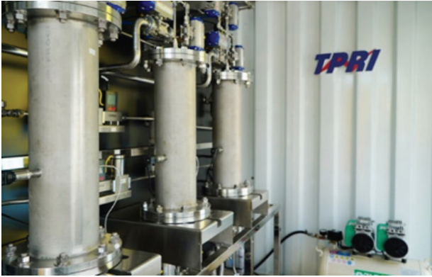
圖 5 三塔式變壓吸附分離主設備
