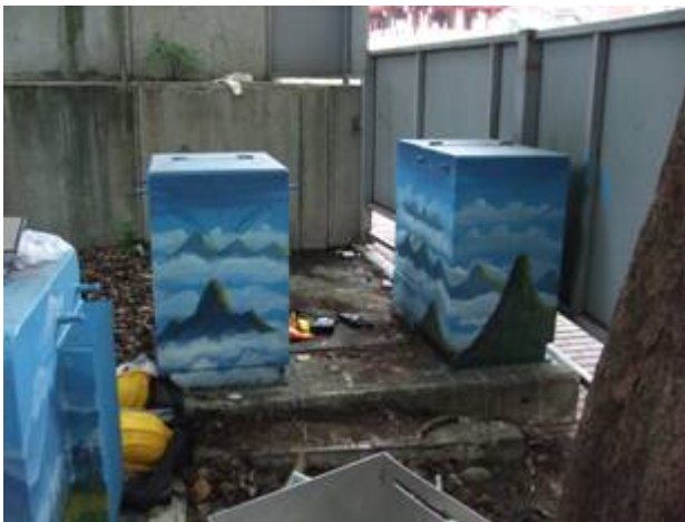
圖1、未裝置屏蔽鋁板前之站台式變壓器
