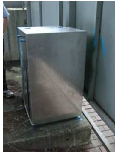
圖2、裝置屏蔽鋁板後之站台式變壓器
