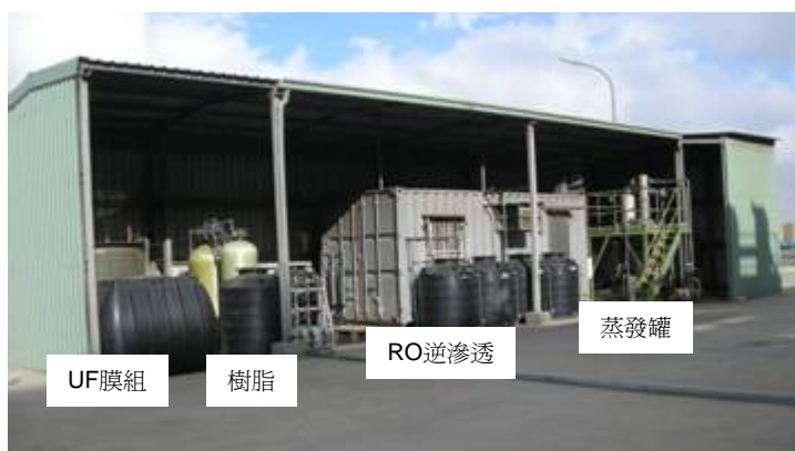
圖1、脫硫廢水最佳化處理系統設備
