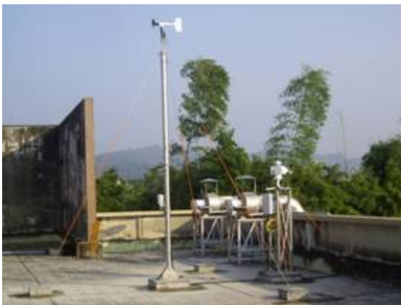
圖1、直達日射量測設備於南投區處檢修大樓安裝實體圖
