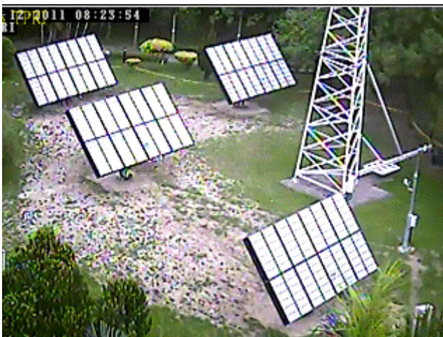
圖1、綜研所樹林所區 10 kWp HCPV 示範系統
