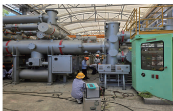
明潭發電廠 #6 發電機綜 合絕緣試驗 (114/05)
