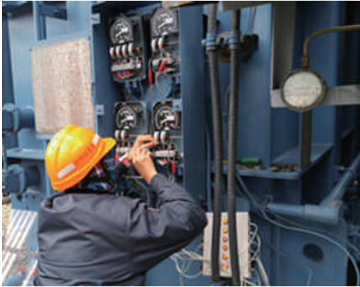
發電廠變電所監控儀表定期校驗
