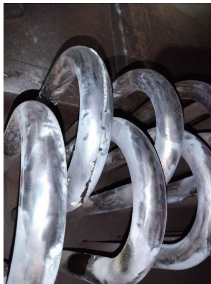
資料來源：本研究提供 圖 1 低壓過熱器爐管破損外觀
