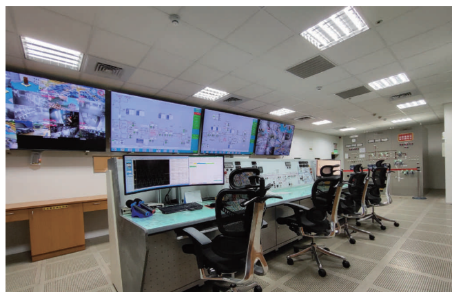
短路試驗室控制室
