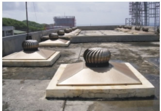
圖4 廠房頂部安裝自然通風扇
