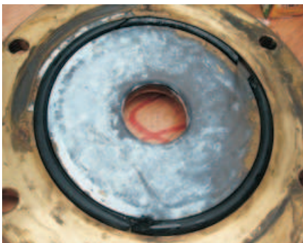
圖 4 上部金屬蓋板 O 型環 (165) 破裂
