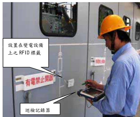
圖1 使用巡檢記錄器及RFID標籤進行二次變電設備巡檢
