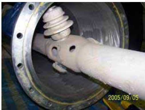
圖 1 GIB 滑動支撐碍子掉落情形
