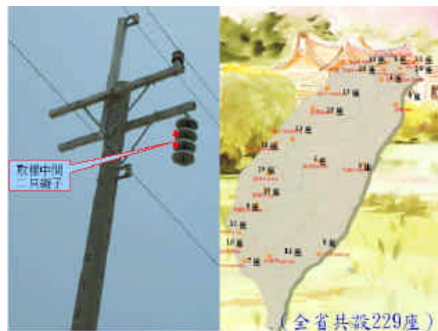
圖3 配電系統現場吊掛鹽害測試架及數量分布
