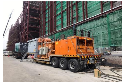
電廠變壓器遞升加壓試驗 Applied AC Voltage Test
