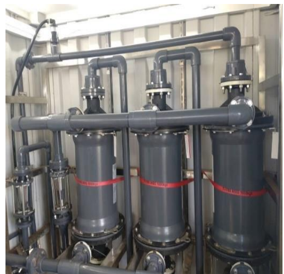
氨氮廢水試驗設備
