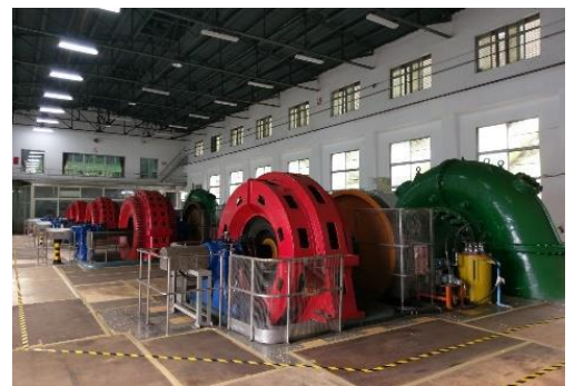
水輪機組調速機性能試驗 Hydro-generator Units Governor Test
