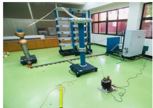
衝擊電壓試驗設備 Impulse Voltage Testing
