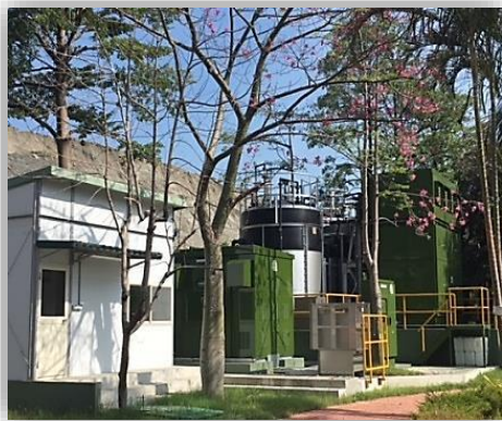
鈦液流電池儲能系統
