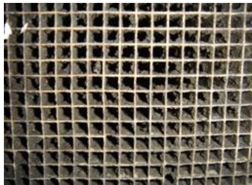
圖1、#5機煙氣進口BASF舊觸媒外觀
