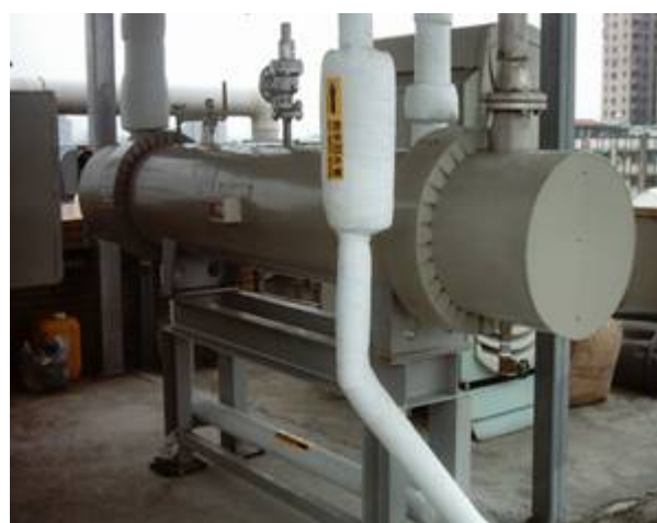
圖2、微型氣渦輪機廢熱回收熱交換器
