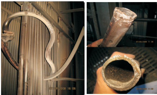
圖 1 破損爐管外觀
