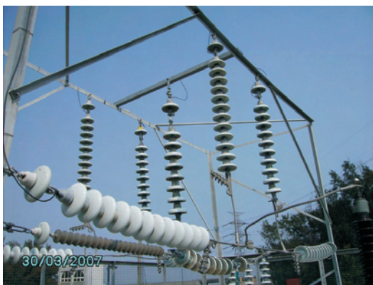
圖 2 彰濱 161kV 長期加壓測試場吊掛試樣
