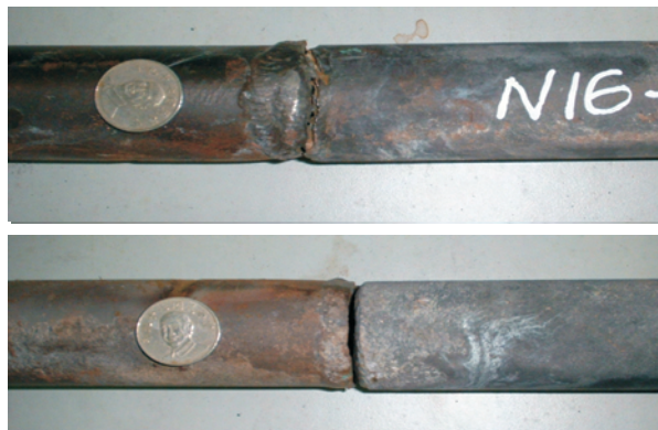
圖 2 T91 與 TP347H 損壞爐管組合後之銲道與圓周裂縫外觀，顯示圓周銲冠寬度不一
