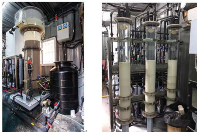
圖 1 流體化床結晶槽與離子交換樹脂塔
