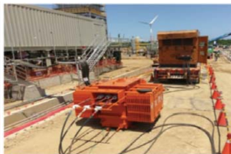
大潭 G/S 變壓器加壓測試 (106.07)
