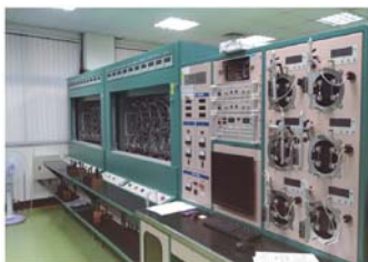
低壓 AMI 自動試驗電表設備
