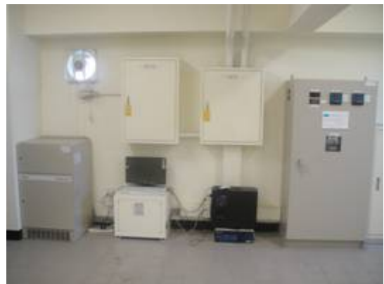
圖2、電氣機房內配置之逆變器及監測設備
