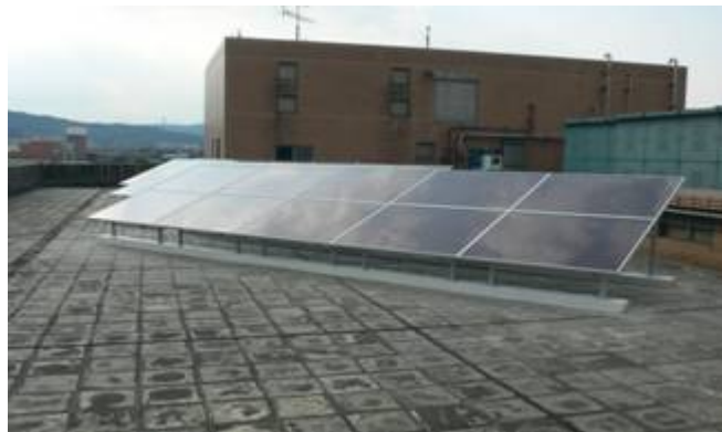
圖1、綜研所薄膜型3kWp太陽光電示範系統
