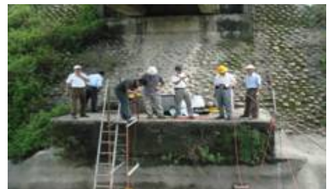
明渠超音波流量計裝置安裝
