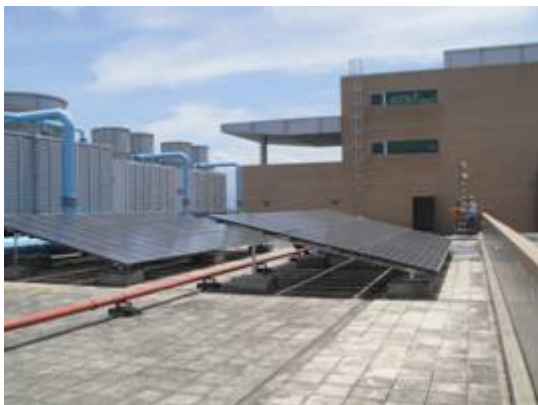
圖1、10kWp矽晶型太陽光電示範系統外觀
